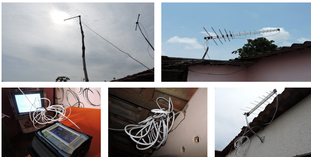
Figura 5. Exemplos de instalações de antenas e sobra de cabo
